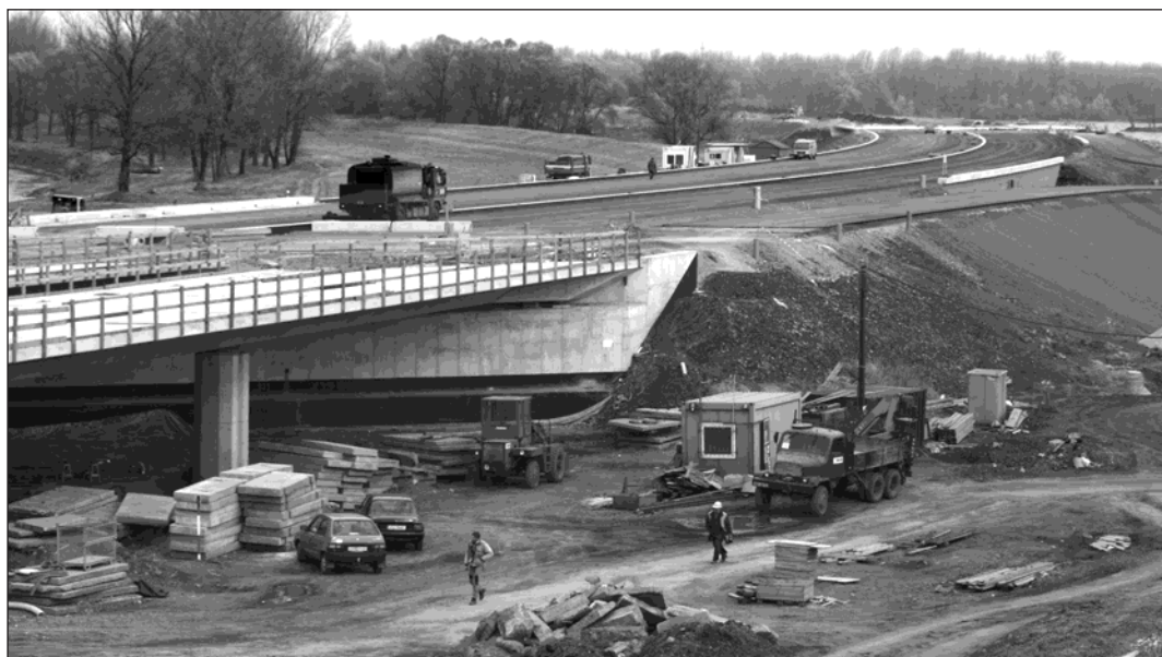
▲ Nové dálniční těleso směřuje od skládky komunálních odpadů v Hrušově kolem Vrbického jezera k mostu přes řeku Odru. Foto: František Krejzek
