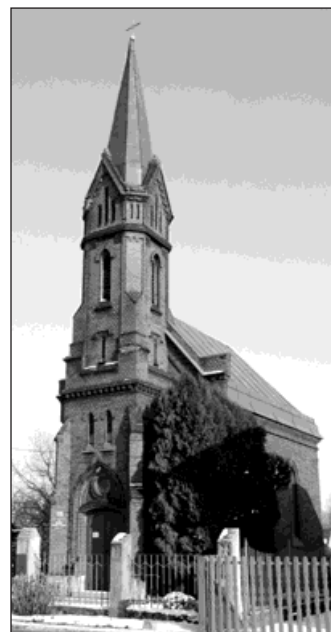
Filiální kaple Panny Marie byla značně poškozena při povodni v roce 1997.
