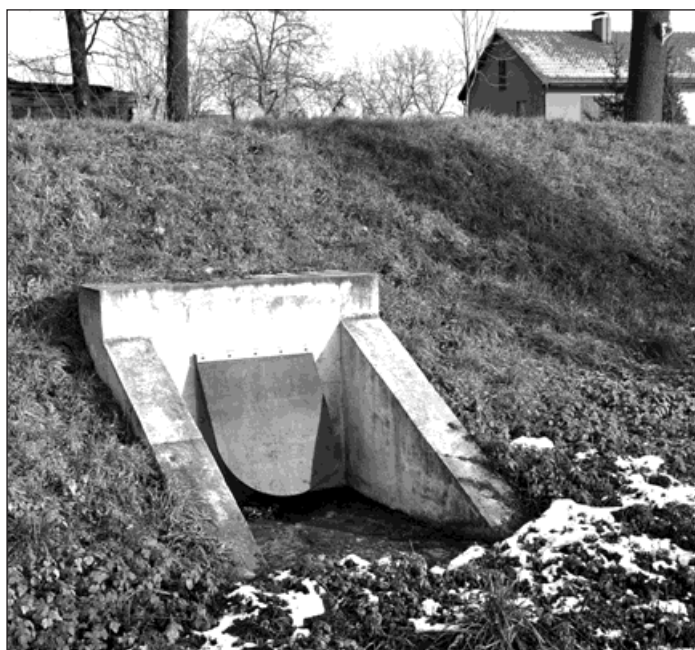
Protipovodňové opatření na Bohumínské stružce. Pokud by voda stoupala až k potrubí, nově nainstalované klapky ho utěsní. Foto: Ervín Hudler
