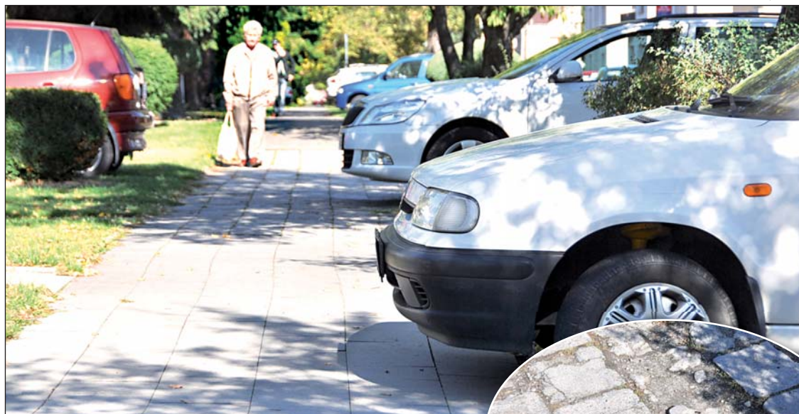
Chodník v Šunychelské ulici si opravu zaslouží. Je ale třeba vyřešit parkování aut. Foto: Pavel Čempěl
