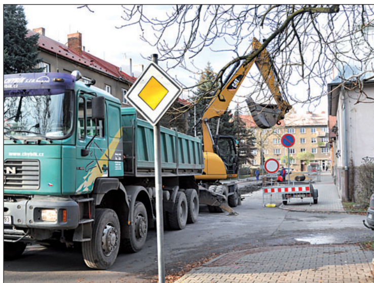
V Husově ulici byly opět k vidění výkopy a těžká technika. Na vině byla prasklá kanalizace. Foto: Pavel Čempěl
