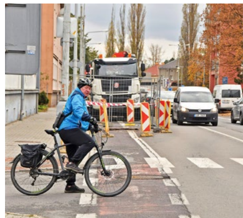
Oprava nemohla být zahájena dříve z důvodu havárie na vodovodu, kterou odstraňuje vlastník sítě před opravou silnice.
